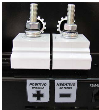
Figura 3-7. Terminales de conexión DC para baterías.
